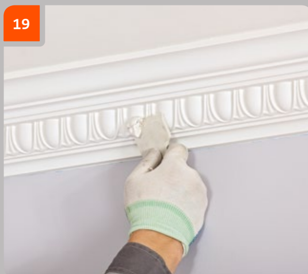
19 Remplir la zone traitée avec un joint fin soluble à l'eau pour les travaux intérieurs et répéter l'étape 18 jusqu'à obtenir une surface plane.
